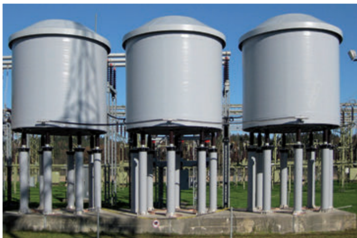
Маломощные шунтирующие реакторы на 30 кВ (Австрия)
