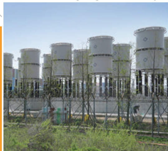
Токоограничивающие реакторы на 345 кВ (Южная Корея)
