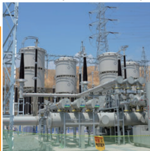
Токоограничивающие реакторы на 345 кВ (Южная Корея)
