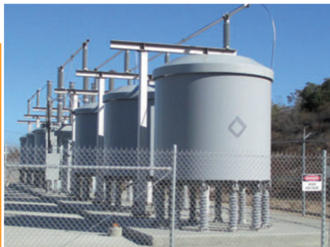
Шунтирующие реакторы на 69 кВ (США)
