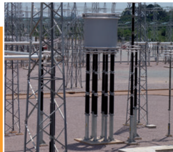
Сглаживающий реактор HVDC (высоковольтная линия электропередачи постоянного тока), 600 кВ (Бразилия)
