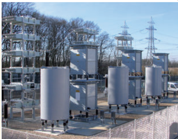
Реакторы с фильтром перем. тока в энергопередающей системе на 225 кВ (Франция)
