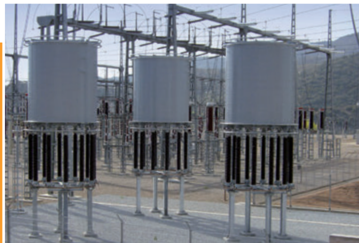
Reactores de flujo de 225 kV (Portugal)
