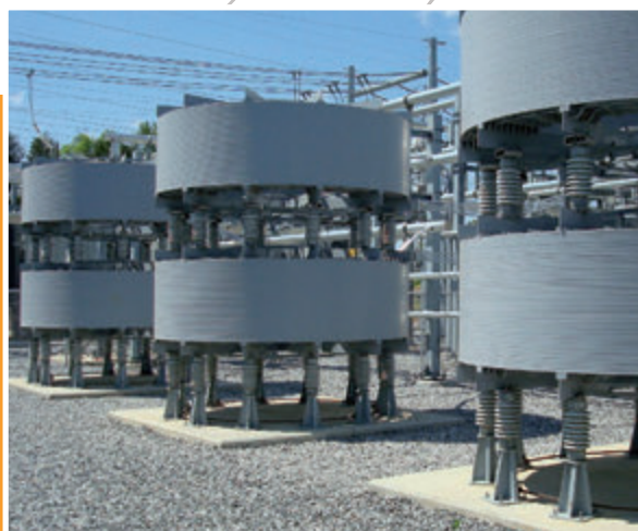
Reactores controlados por tiristores (EE.UU.)
