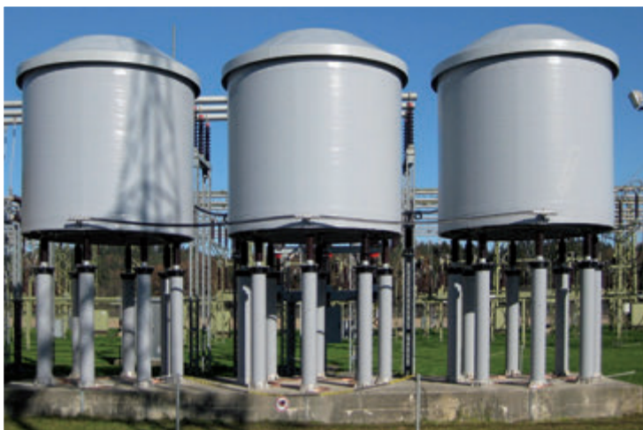
Reactores de derivación de bajo ruido de 30 kV (Austria)
