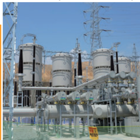
Reactores limitadores actuales de 345 kV (Corea del Sur)
