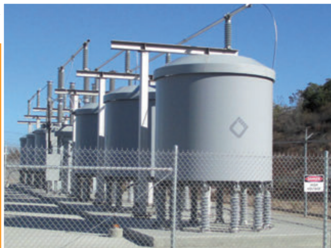
Reactores de derivación de 69 kV (EE.UU.)
