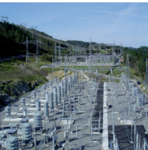
Reactores de filtro armónicos AC (Noruega)
