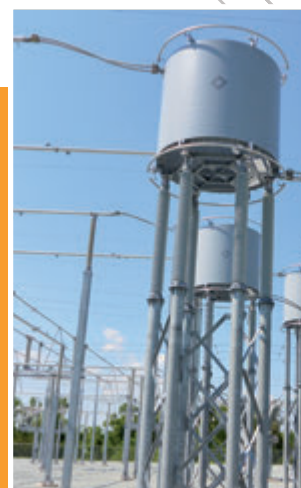
Reactores limitadores actuales de 230 kV
