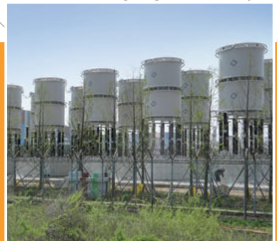
Reactores limitadores actuales de 345 kV (Corea del Sur)
