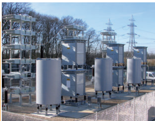
Reactores de filtro AC en el sistema de transmisión de 225 kV (Francia)
