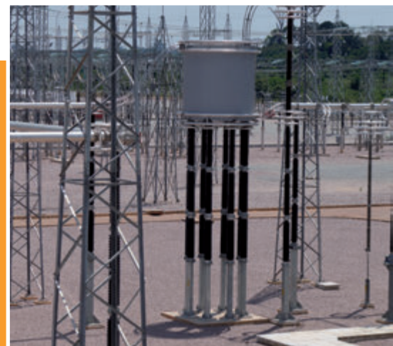
Reactor de alisamiento HVDC de 600 kV (Brasil)
